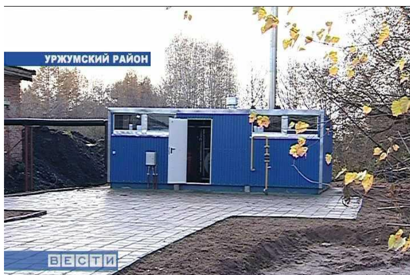
Фото 3.6-2. Модульная котельная в с. Петровском 43 .
